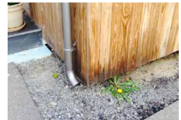
Kledning montert med 10 cm avstand til mark. Resultatet er misfarging.
