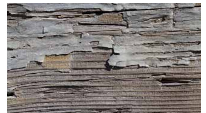
Gammel nedbrutt kledning.
