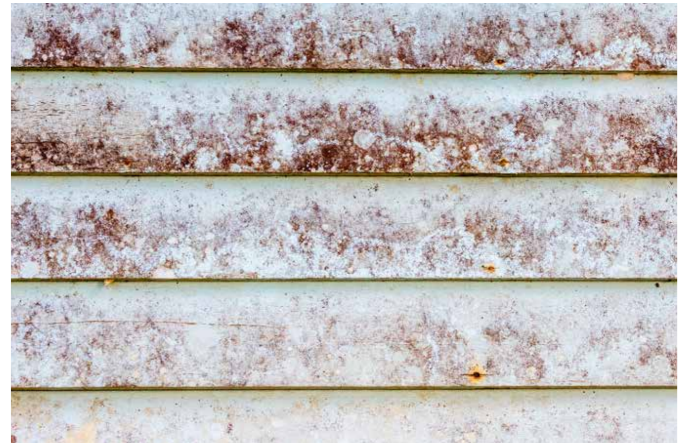
Kledning angrepet av sopp.
